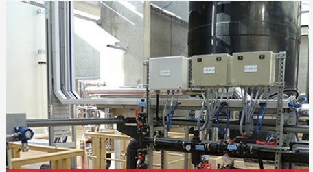
EDF Cattenom - Installations de traitement antitartre et de traitement biocide
