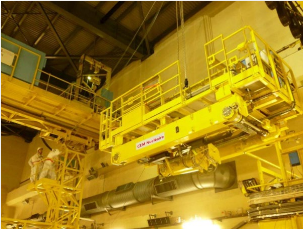
EDF : Chariot Pont Auxiliaire 20 tonnes
